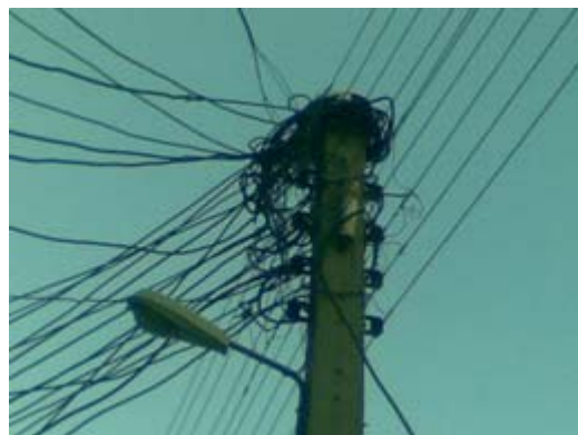
شکل (۱): فازیابی نادرست مشترکین به علت پیچش بیش از حد سیم‌ها
